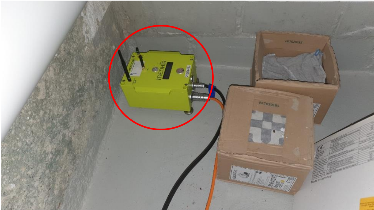
MP UG2: UG Heizung unter Treppe
