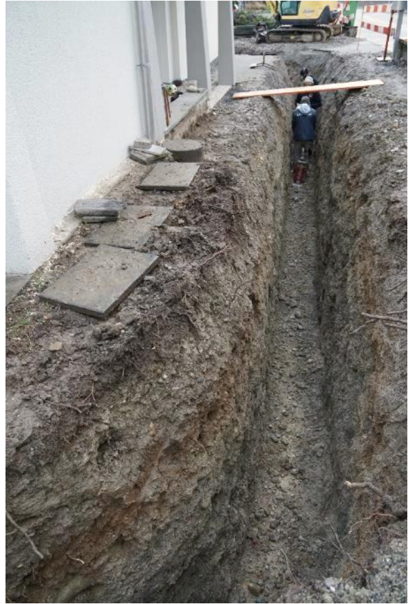
Offener Bodenschlitz Zentraler Bereich
