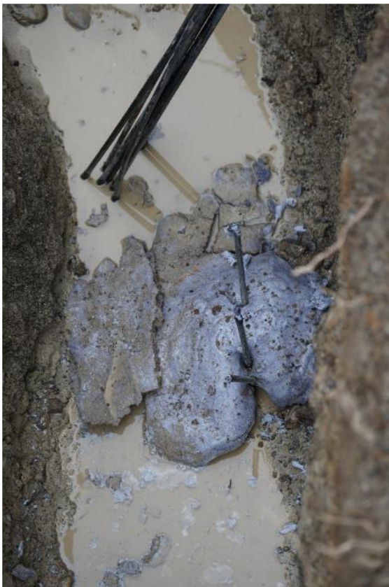
Kunstharzaustritt der Injektion
