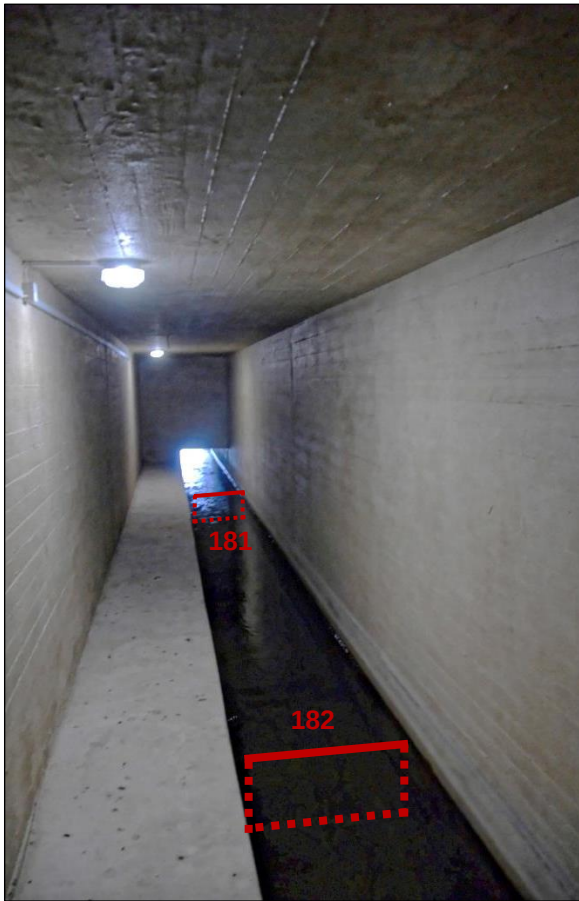
Abb. 54: Kanal der Fischaufstiegshilfe im Innern des Krafthauses mit den Positionen der Antennen Nr. 181 und 182
