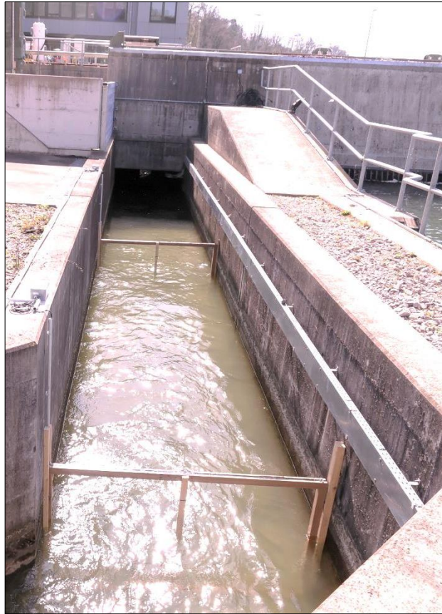
Abb. 37: Blick auf den strukturlosen Einlaufkanal mit den Antennen Nr. 133 und 134
