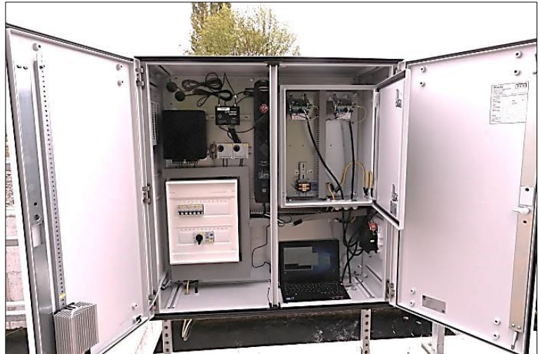
Abb. 7: Schaltschrank am Einlaufbau- werk des Umgehungsgerinnes Ryburg-Schwörstadt (D)
