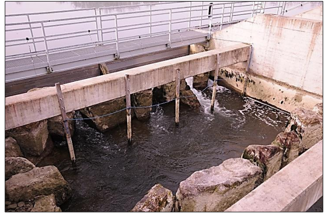
Abb. 52: Seilantennen Nr. 174 zwischen zwei Steinriegeln im linken, offenen Kompartiment des Einlaufbauwerks
