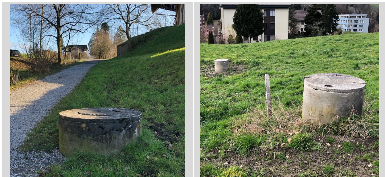
Abbildung 21: Ehemals ebenerdig abgeschlossene Schächte einer Aushub-/Siedlungsabfalldeponie. Setzungen entstehen sowohl durch die Verdichtung des Abfalls wie auch durch die Zersetzung von organischem Material. Links: Schacht am Deponierand mit einem Setzungsbetrag von 45 cm über 40 Jahre. Rechts: zwei Schächte im Zentrum auf der gleichen Deponie mit Setzungsbeträge 59 cm resp. 93 cm (Schacht vorne).
