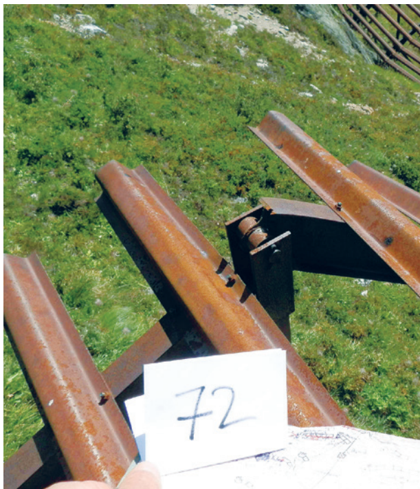
Fig. 116: Poutrelle IPE rompue à la suite d'un recouvrement par la neige pour un ouvrage «BEDO» à Rinistock, Meien-Wassen (UR). Lorsqu'un ouvrage est recouvert de neige, le moment en flexion maximal s'exerce sur la poutrelle dans la zone du raccord au pilier (photo: R. Planzer, 29.08.2018).
