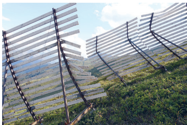
Fig. 124: Barrière contre la neige soufflée endommagée à Valtschamela, Churwalden (GR). La barrière est constituée d'éléments larges de 4 m, ancrés par quatre micropieux. La pression latérale de la neige a déformé la barrière vers l'aval (photo: SLF/S. Margreth, 17.08.2018).
