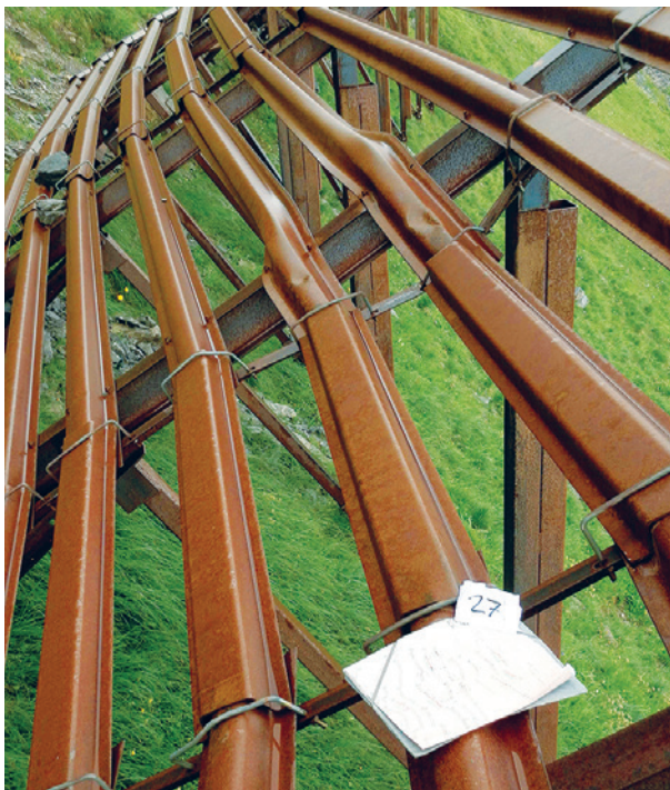
Fig. 117: Traverses de claies déformées sur un ouvrage «Züllig SA» à Ob der Mettenenalp, Unterschächen (UR) (photo: R. Planzer, 08.08.2018).
