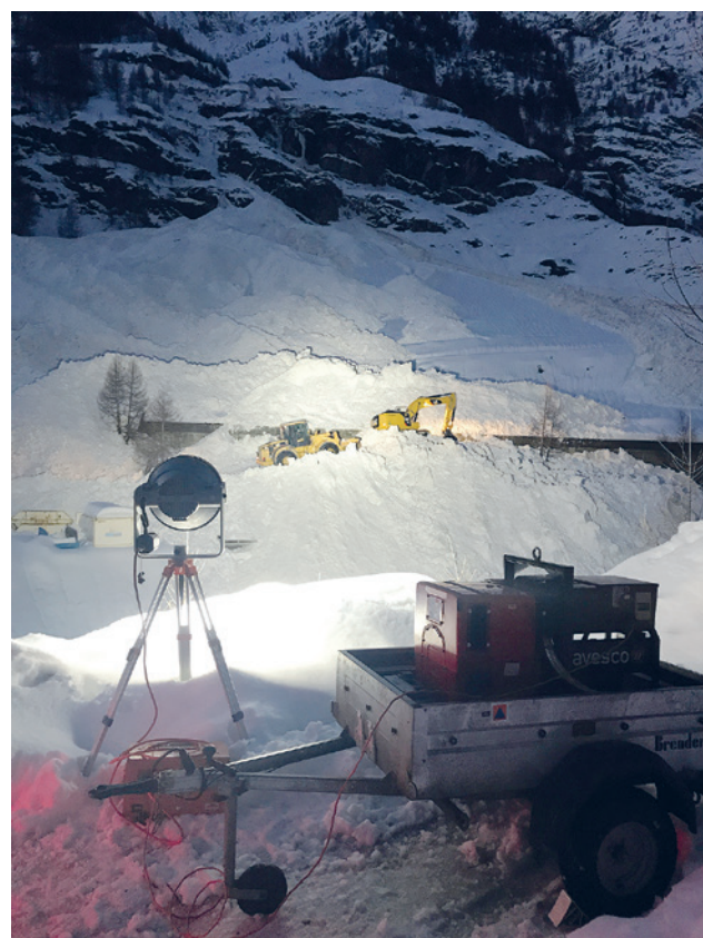
Fig. 140: Dépôts d'avalanche de grande épaisseur sur la route Täsch-Zermatt (VS) dans le parcours d'avalanche du Luegelbach. Déblaiement avec pelleuse et chargeuse sur pneus, également la nuit (photo: P. Steffen, 10.01.2018).
