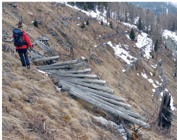
Fig. 121: L'avalanche du «Val da Barcli» du 23 janvier 2018 a détruit environ 460 m de râteliers de type SLF avec sabot de traverse. La fixation du pilier sur la plaque de base s'est révélée un point faible lors de l'impact de l'avalanche. Le pilier n'étant pas fixé à la plaque de base, des forces relativement faibles suffisent pour le repousser. Les piliers et les longrines ont été arrachés sur pratiquement tous les ouvrages détruits (photo: SLF/S. Margreth, 27.03.2018).
