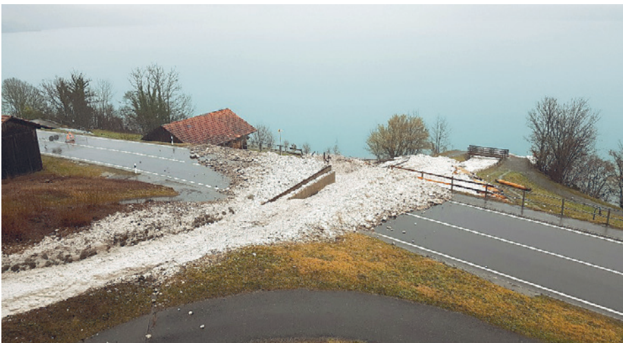
Fig. 99: Route principale ensevelie près de Brienz (photo: Thuner Tagblatt, janvier 2018)
