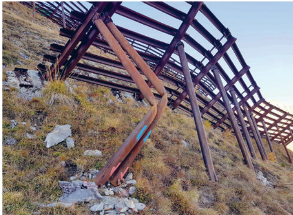
Fig. 112: Piliers périphériques pliés sur les ouvrages « Dickru » de La Loutze, Leytron (VS). Des forces accrues de pression de la neige s'exercent en périphérie. C'est pourquoi l'ouvrage a été renforcé avec des montants et piliers doublés en périphérie (photo: Nivalp SA, 12.11.2018).
