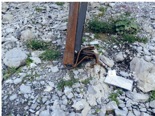
Fig. 114: Pattes de fixation de pilier tordues sur des ouvrages «Voest-Alpine BT» de Grotzenegg, Unterschächen (UR) (photo: R. Planzer, 22.08.2018).
