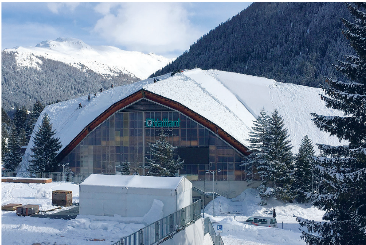
Fig. 37: Au début de février 2018 la neige a été dégagée sur toute la surface de la patinoire de Davos pour éviter des problèmes structurels en cas de grosses chutes de neige ultérieures. Lors du dégagement de la neige d'un toit, l'équilibre statique de la structure doit être respecté. Un dégagement d'un seul côté, ou bien des amas locaux doivent être évités. Les personnes travaillant sur le toit de la patinoire étaient assurées avec des cordes. Le déblaiement de la neige des toitures ne doit être effectué que par des personnes formées (photo: SLF/S. Margreth).
