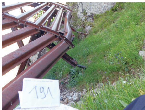
Fig. 118: Sous l'influence de la pression de la neige (entre autres en raison du fort glissement) et d'un trop grand espacement entre la traverse inférieure et le sol, l'ancrage de traction amont de l'ouvrage «Züllig SA» de Rinistock, Meien-Wassen (UR), a été déformé (photo: R. Planzer, 29.08.2018).
