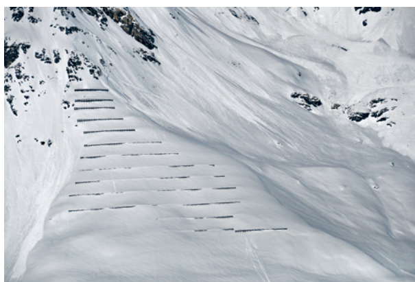
Fig. 109: Ouvrage de retenue de Cavistrau, Trun (GR), partiellement recouvert de neige le 24 janvier 2018. En partie supérieure de l'équipement, les ouvrages présentent une hauteur de 4 m, et plus bas de 3,5 m (photo: SLF/S. Margreth).
