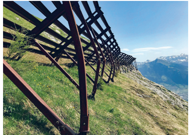
Fig. 113: Piliers pliés des ouvrages « Züllig SA » à Stelli, Untervaz (GR). Des dommages aux piliers ont déjà été constatés sur cet ouvrage au cours des hivers 1994/95 et 1998/99 (photo: M. Kalberer, 30.05.2018).
