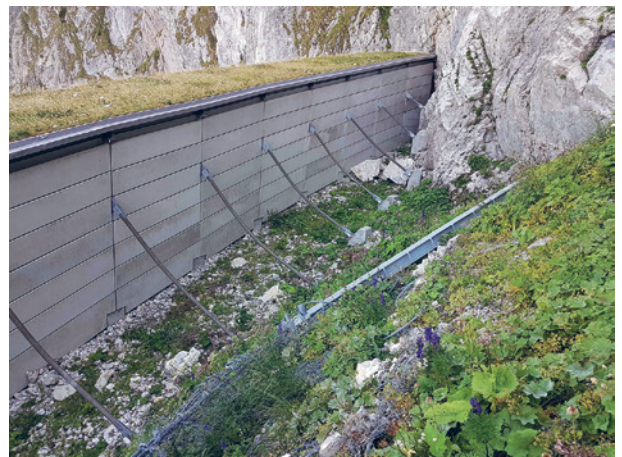
Fig. 135: Les poutres de soutien amont de la galerie Naye Aval ont été tordues ou rompues par la pression de la neige. En outre, quelques poutrelles en acier ont été déformées (photo: Geobrugg, 22.08.2018).
