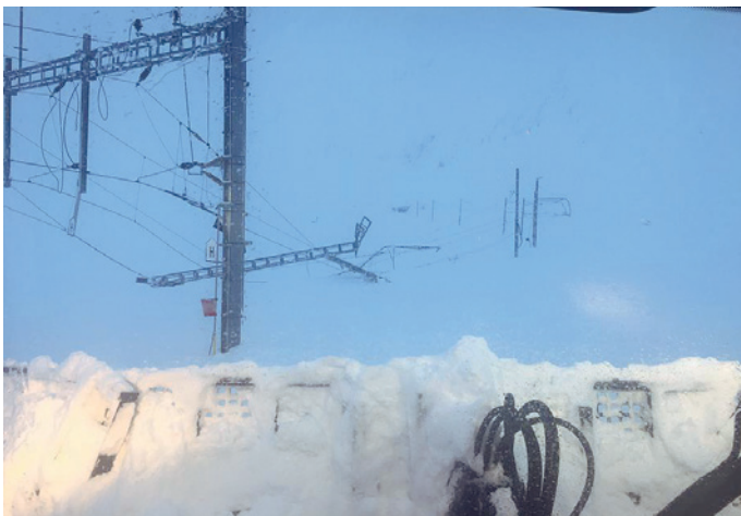
Fig. 73: La caténaire endommagée en soirée du 22 janvier 2018. Vue de la gare du col de l'Oberalp dans la direction du tunnel sur le versant uranais (photo: Andermatt-Sedrun Sport AG, 22.01.2018).
