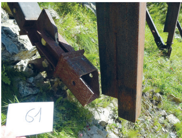
Fig. 115: Sabot de pilier plié sur un ouvrage «Züllig SA» avec double poteau renforcé à Rinistock, Meien-Wassen (UR) (photo: R. Planzer, 29.08.2018).
