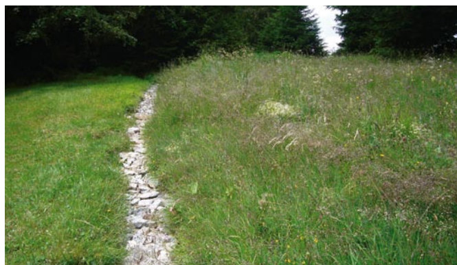
Fig. 86 > Canaletto di drenaggio riempito di sassi
