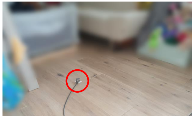
MP6 EG Kinderzimmer
