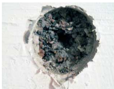
Figura 13, Esempio di isolamento di sughero catramato dietro un intonaco. Fonte: Bayerisches Landesamt für Umwelt (LfU), Rückbau schadstoffbelasteter. Bausubstanz. Arbeitshilfe Rückbau: Erkundung, Planung, Ausführung, 2019.
