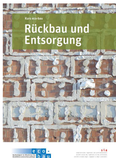
Figura 23 Locandina di un corso EcoBau - SIA. È illustrata una parete esterna a cui sono stati rimossi i pannelli isolanti. Sulla struttura muraria rimane l'adesivo usato per la posa dei pannelli.
