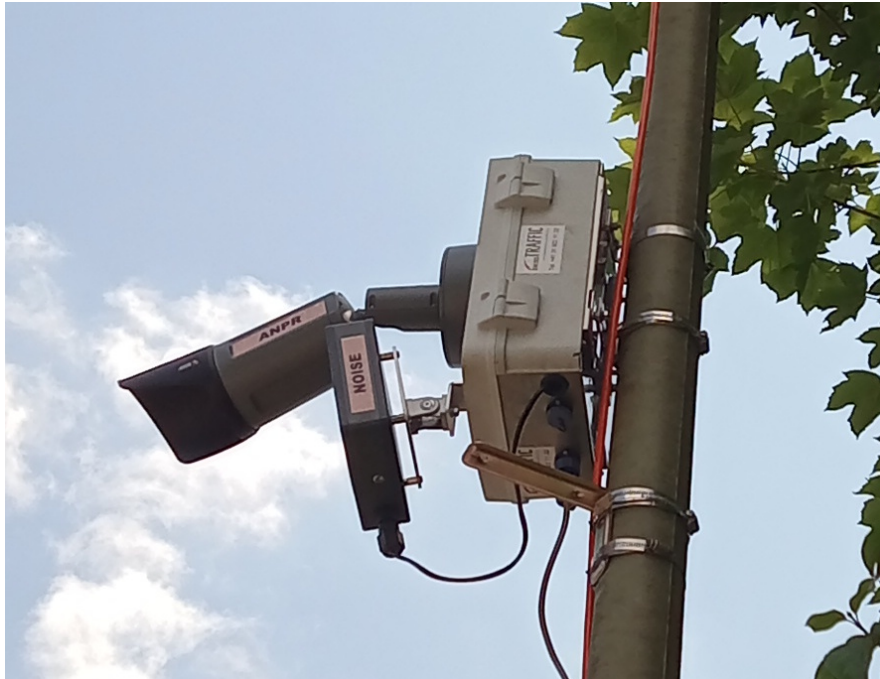
Abbildung 2: swissNoise Lärmblitzer bestehend aus einer Kamera mit Infrarot-Nachtsichteinheit für die automatische Nummernschilderkennung (automatic number plate recognition, ANPR). Das Mikrofonarray befindet sich im rechteckigen Gehäuse mit der Aufschrift Noise. Die Stromversorgung, Logikeinheit und Steuerung des Lärmblitzers befinden sich in der hellgrauen Box, welche mit Schneckengewindeschellen an der Kandleberstange montiert ist.
