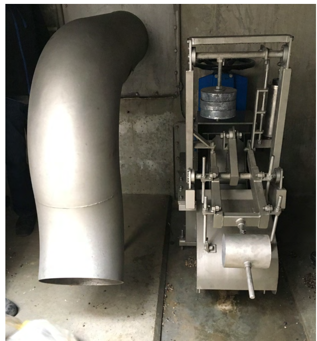
Fig. 80: A destra la valvola di regolazione del deflusso e a sinistra lo sfioratore d'emergenza della parte destinata alla ritenzione
