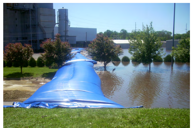
Fig. 93: Argine di protezione mobile riempito di acqua
