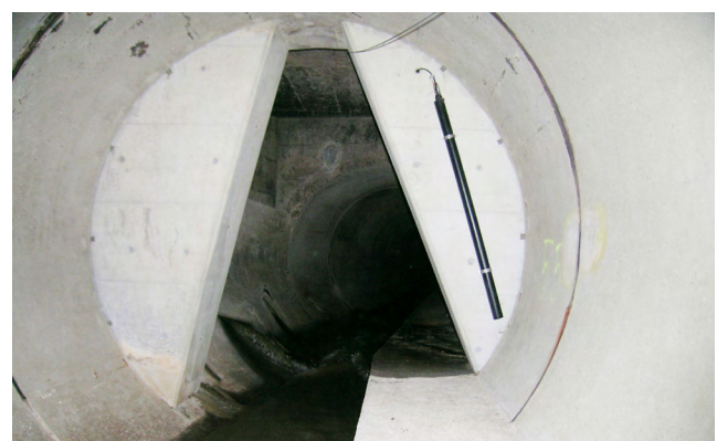
Fig. 72: Canale d'apporto a Köniz con diaframma di strozzamento. Nel tubo di protezione nero si trova una sonda per la misurazione del livello dell'acqua.
